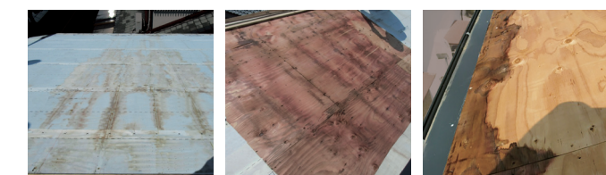
透湿ルーフィングの変色 野地合板の腐朽 雨水による軒先の変色
